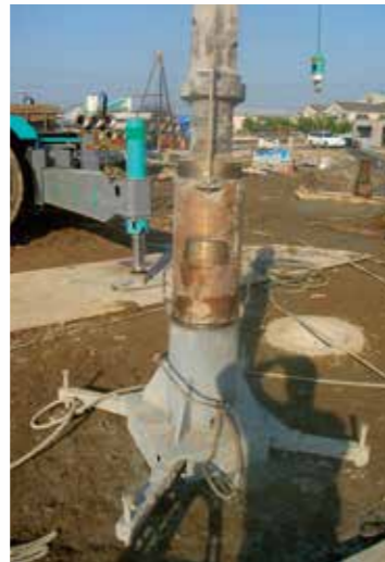
外管閉塞状態
