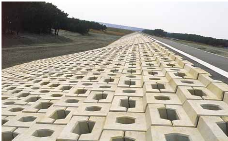
緩傾斜護岸 建設省静岡河川工事事務所 駿河海岸川尻堤防工事 サーフブロック2TON型 3割勾配にて施工
