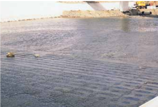
護床工 三重県久居土木事務所 長野川災害復旧助成工事 サーフブロック2TON型
