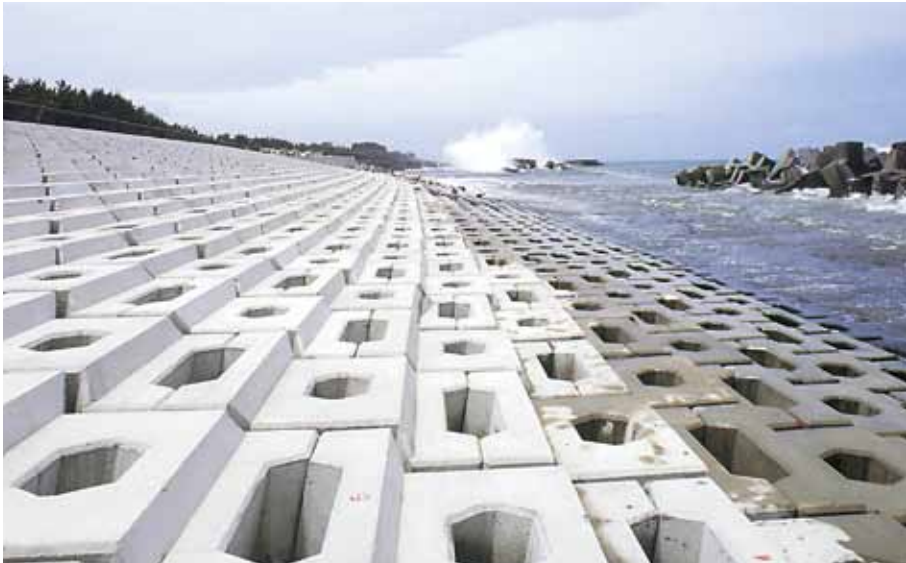
緩傾斜護岸 富山県入善土木事務所 大屋海岸侵食対策工事 サーフブロック2TON型 5割勾配にて施工
