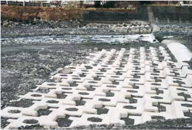
護床工 静岡土木事務所 安倍川維持修繕工事 サーフブロック2TON型
