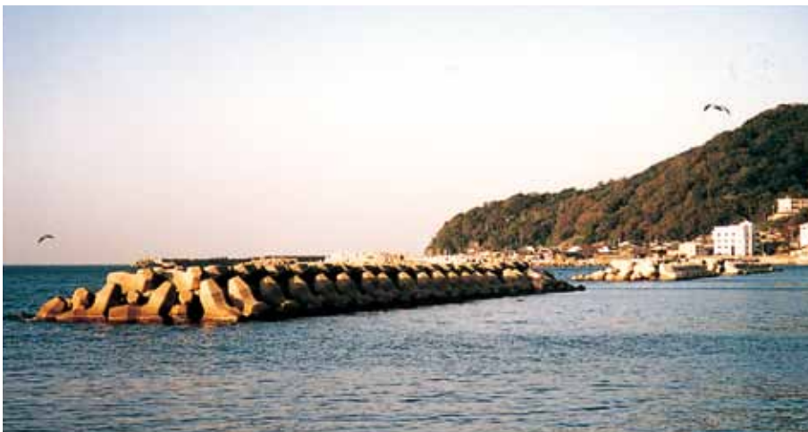
被覆工 福井県丹生耕地事務所 県営越廼海岸環境整備事業 サーフブロック8TON型
