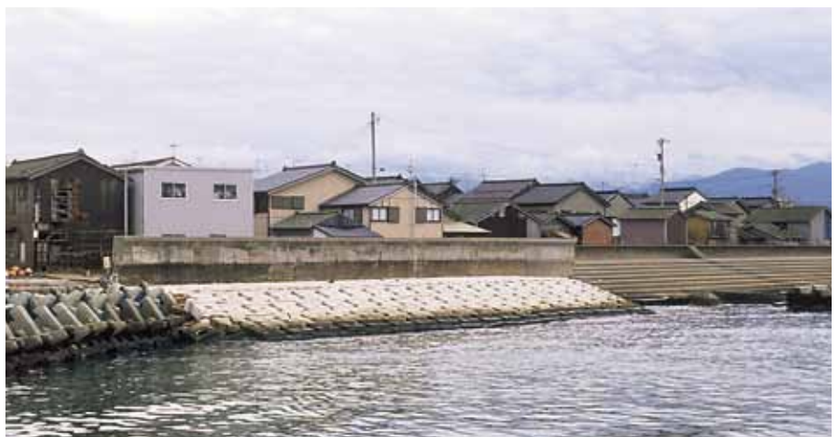
被覆工 富山県入善土木事務所 黒部漁港海岸侵食対策根固工事 サーフブロック2TON型
