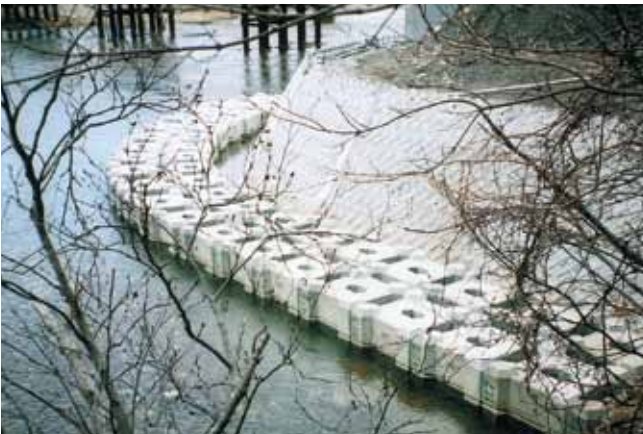
根固工 北海道開発局室蘭開発建設部 一般国道336号様似町幌満トンネル新設工事 サーフブロック2TON型
