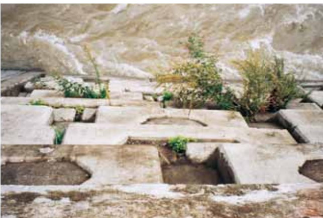
護岸工 長野県大町建設事務所 平成7年度災姫川河川災害復旧工事 サーフブロック4TON型
