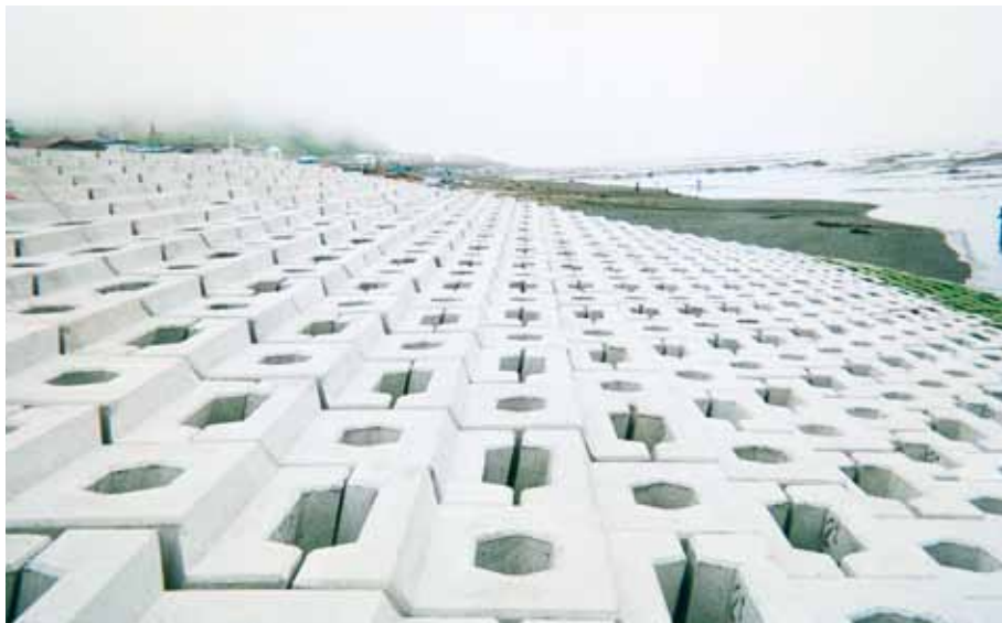
緩傾斜護岸 北海道室蘭土木現業所 荻伏漁港海岸浸食対策工事 サーフブロック2TON型 4割勾配にて施工
