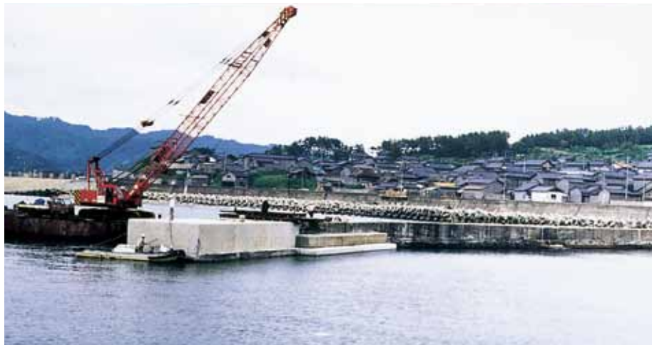
被覆工（混成堤マウンド） 石川県門前町役場 黒島漁港局部改良工事 サーフブロック2TON、4TON型
