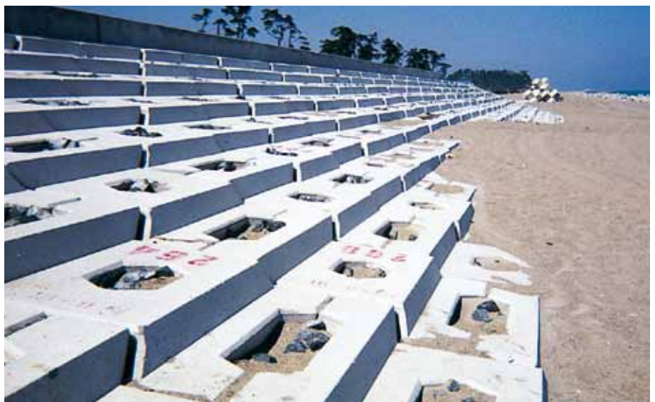
緩傾斜護岸 福島県相双建設事務所 木崎海岸局部改良工事 サーフブロック2TON型 3割勾配にて施工
