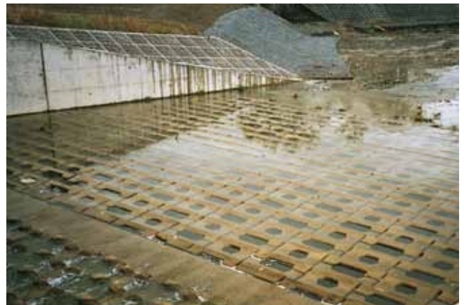
護床工 滋賀県八日市土木事務所 佐久良川災害関連工事 サーフブロック2TON型
